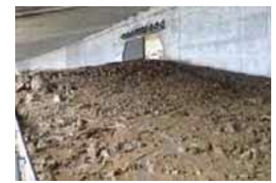
▲ 平成28年大雨等災害による覆道内への土砂流入 道道108号 (利尻富士町)
