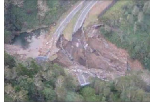
国道274号（日勝峠）の道路洗堀
