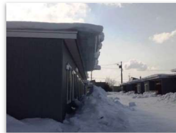
緩勾配屋根における氷板のせり出し
