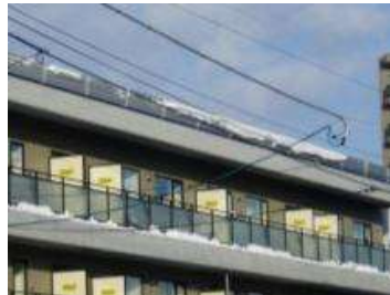
吹き払い式フェンス (札幌市内民間住宅)
