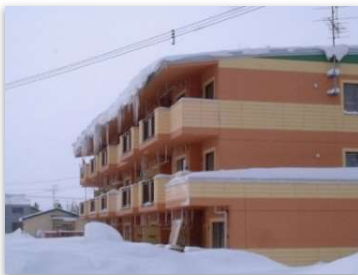
緩勾配屋根軒先の氷柱（つらら）
