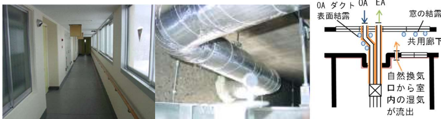
共用廊下に面する部屋の自然給気口から湿気が流れてダクトや窓で結露
