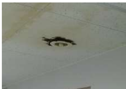
共用片廊下の吸込み口のカビ
