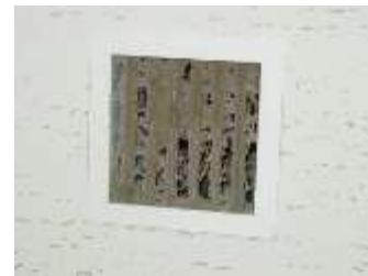
清掃されていない室内グリルフードの防虫網
