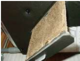
清掃されていない換気装置内のフィルター
