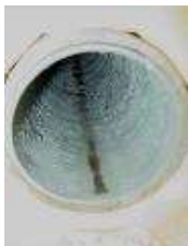
共用片廊下を通る排気ダクト内の結露
