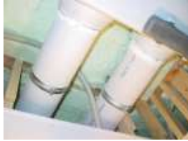
換気装置と外気との耐火二層管に断熱保温がされていない
