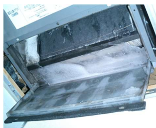
室内からの環気 (RA) 低温化による熱交換器内の結氷
