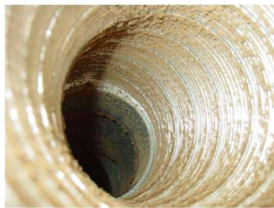
アルミフレキシブルダクトの内面の汚れ
