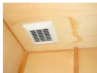
天井断熱上の小屋裏配管の室内吹出し周辺結露
