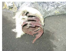
ダクトの塩害
