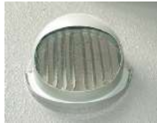
清掃されていない屋外フードの防虫網
