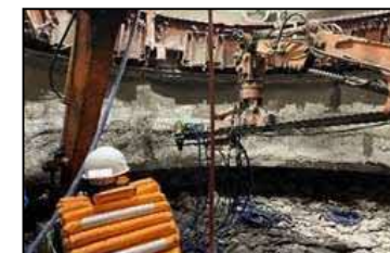
⑥ロックボルト設置 岩盤中にロックボルト（鉄製のロッド）を打ち込み補強します。
