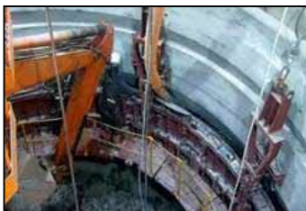
⑧コンクリート打設 設置した型枠と岩盤の壁面の間にコンクリートを流し込みます。
