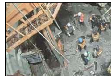
⑨型枠脱型 流し込んだコンクリートが固まった後に型枠を外します。
